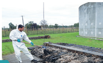
Nettoyage par les équipes du SMEC des « poreux » remplis de lingettes et autres déchets.
