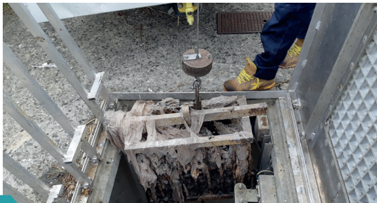
Exemple d'une pompe de relevage hors service à cause des lingettes jetées dans le tout à l'égout.
