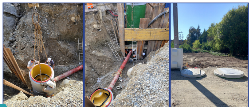
A gauche, pose du nouveau regard / Au milieu, raccordement du regard au nouveau poste de relevage / A droite, le nouveau poste finalisé avec la démolition de l'ancien poste de relevage.
